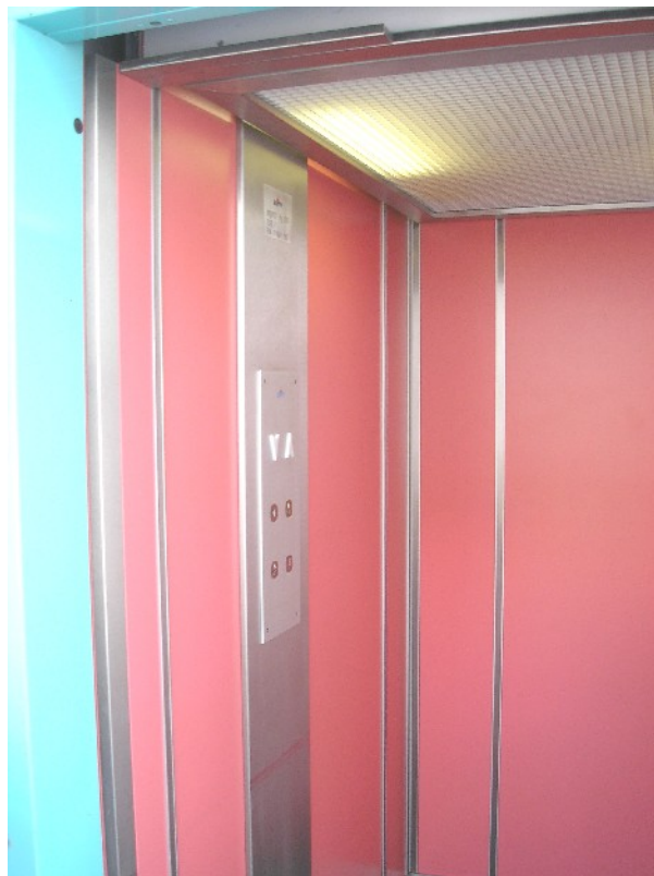
pohľad do kabíny výt'ahu
