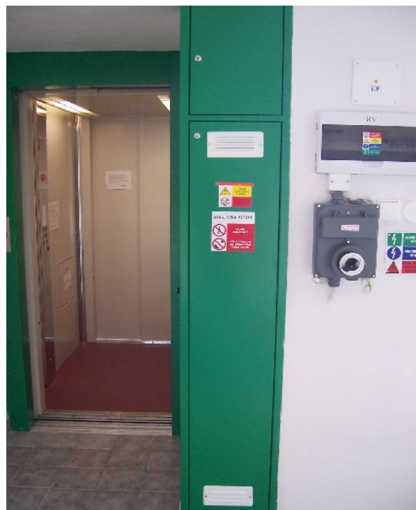
pohľad na rozvádzač v hornej stanici
