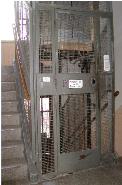
pohľad na OK šachtu a šacht. dvere
