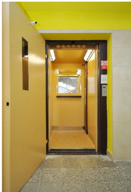
pohľad do kabíny nového výťahu
