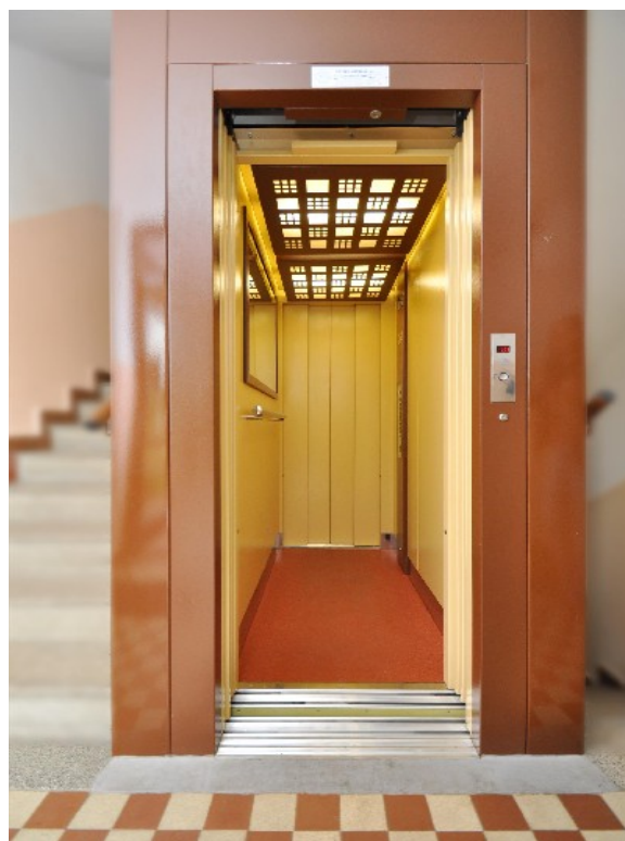
pohľad do kabíny nového výťahu
