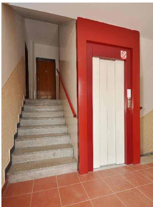
pohľad na OK šachtu a šacht. dvere
