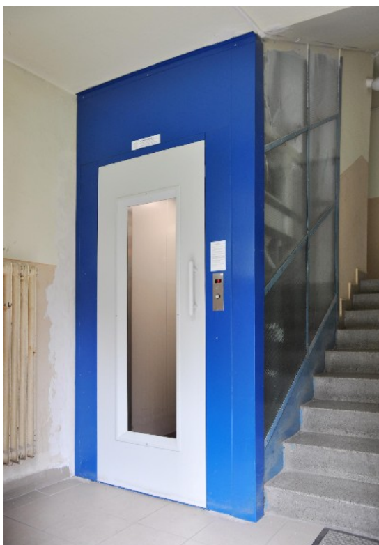
pohľad na OK šachtu a šacht. dvere
