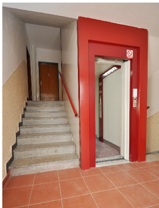
pohľad do kabíny nového výťahu
