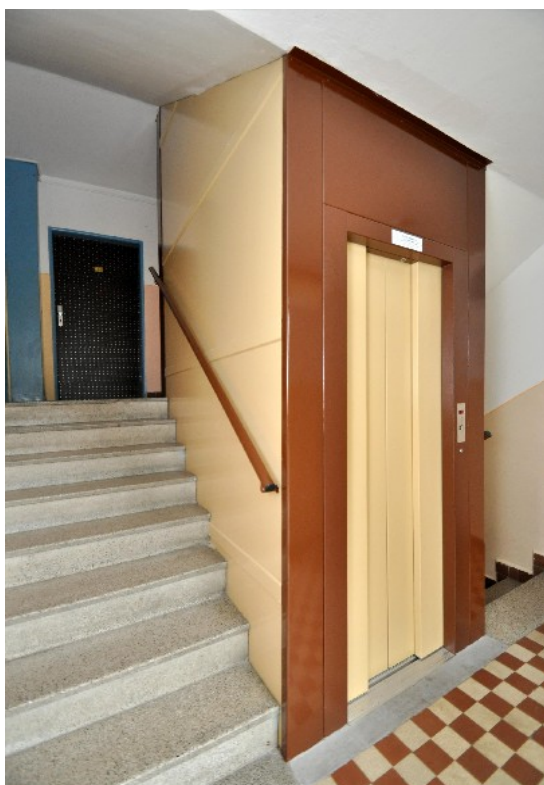
pohľad na OK šachtu a šacht. dvere
