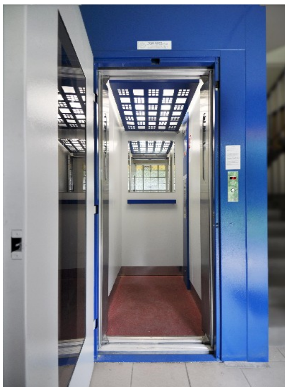
pohľad do kabíny nového výťahu
