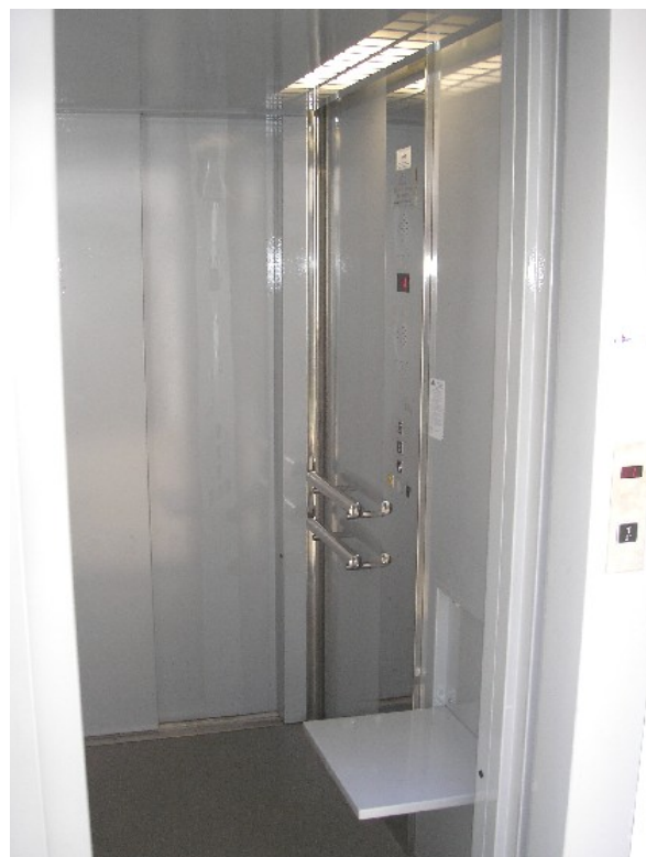
pohľad do kabíny výtahu
