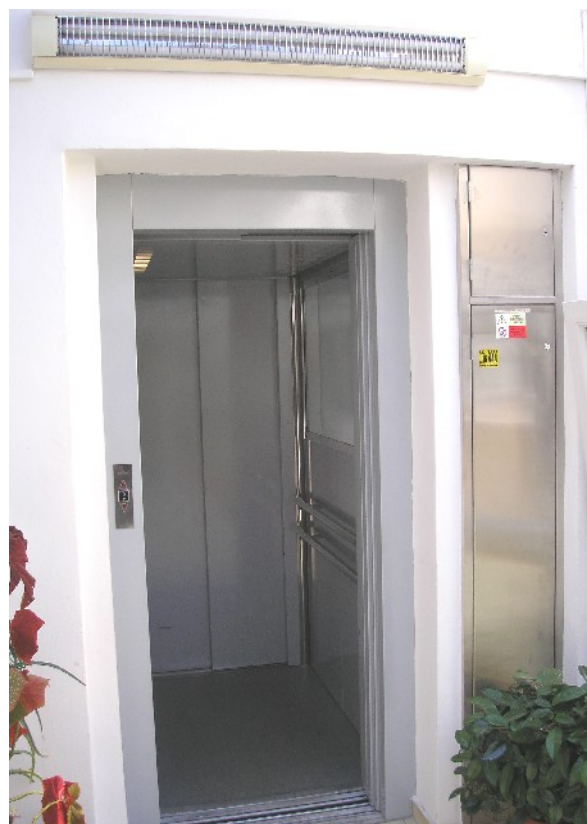
vstup do výtahu 2NP + rozvádzač výtahu
