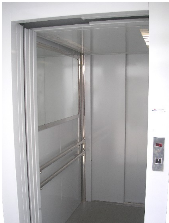
pohľad do kabíny výtahu
